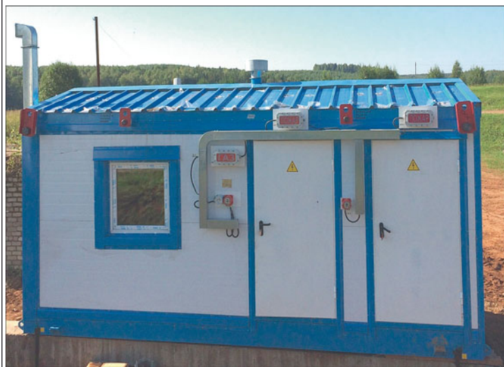
Рис. 2. Блок БППВ-50 на промысловом объекте во время ОПИ
